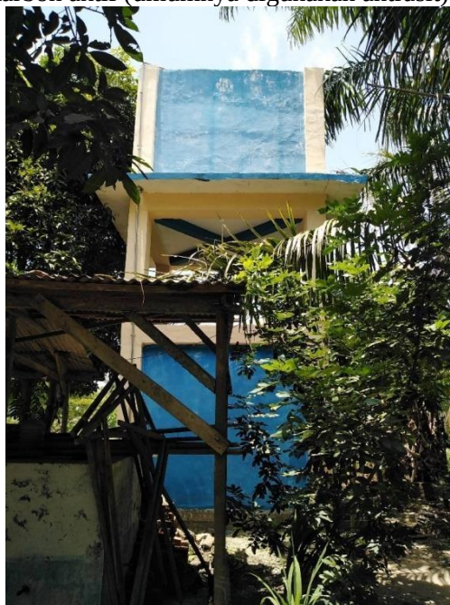
Gambar 2. Tower air untuk instalasi air bersih di dusun III Kelambir
