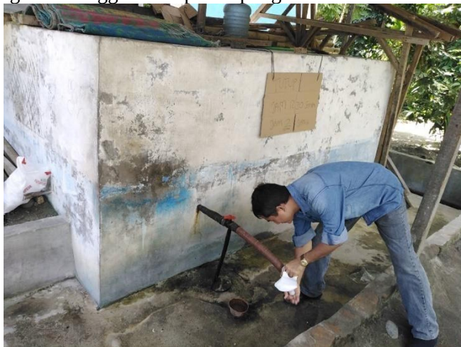
Gambar 1. Instalasi sumur artesis di dusun III desa kelambir
